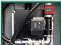
› Wnętrze obudowy dystrybutora
